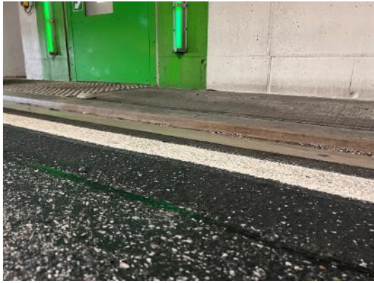
Bild FS12- 4: Abgesenkter Bord des Notgehwegs (Foto: Boenke)
