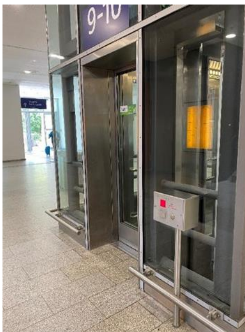
Bild FS02- 5: Für Rollstuhlnutzende in der Bedienehöhe angepasste Bedienelemente vor dem Aufzug (Foto: Eichmann)
