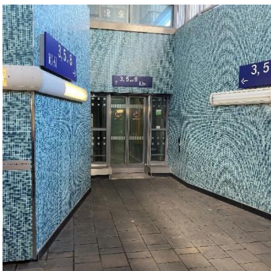
Bild FS09- 6: Zugang zum Aufzug im Fußgängertunnel ohne Bodenindikatoren (Foto: Eichmann)
