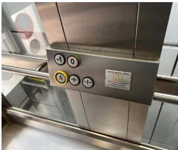
Bild FS06- 6: Bedienfeld in einem Aufzug in rollstuhlgerechter Höhe und mit taktil wahrnehmbarer und visuell kontrastreicher Beschriftung der Tasten (Foto: Boenke)
