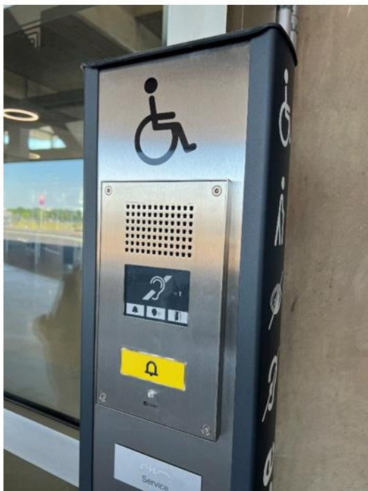
Bild FS05- 4: Call point mit Induktionsschleife und Braillebeschriftung zur Anforderung von Hilfeleistungen (Foto: Boenke)
