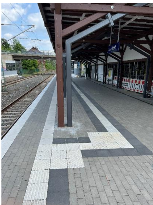
Bild FS06- 4: Bodenindikator-basiertes Leit-system am Hausbahnsteig, Führung um eine Stütze des denkmalgeschützten Bahnhofsdaches (Foto: Boenke)
