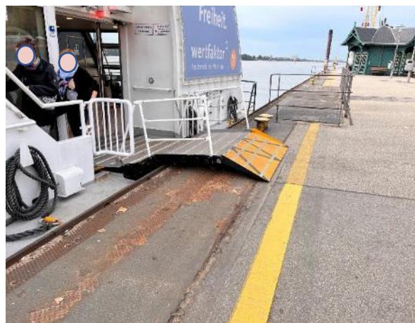
Bild FS19- 5: Heruntergeklappte Fahrgastbrücke mit steilen Rampen auf beiden Seiten und markierte Grenzlinie (bis dort darf die Fahrgastbrücke reichen) (Foto: Boenke)
