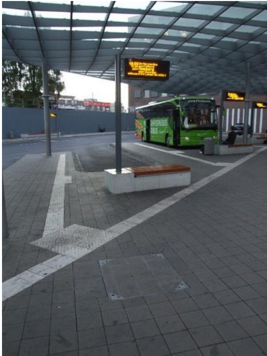
Bild FS04- 6: Bodenindikator-basiertes Leitsystem mit zu geringem Abstand zu Einbauten, dynamisches Fahrgastinformationssystem (Foto: Boenke)
