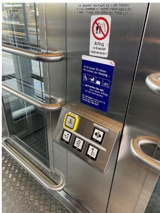
Bild FS02- 6: Aufzüge mit schräg gestelltem Bedienfeld in rollstuhlgerechter Höhe und mit visuell kontrastierenden und taktil beschrifteten Bedientasten (Foto: Eichmann)
