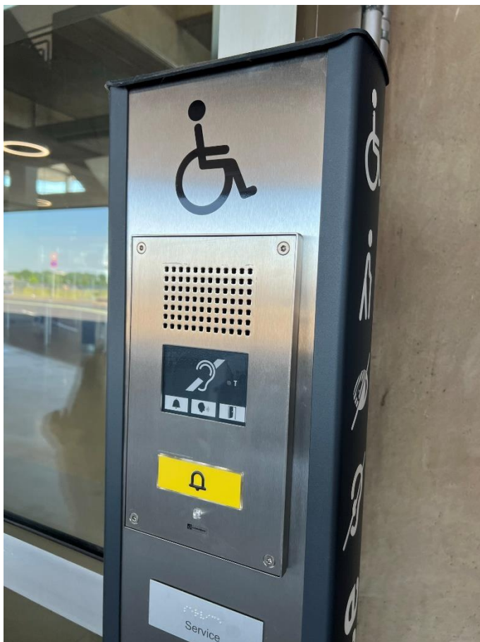
Bild 15: Station (Call-Point) zur Anforderung von Hilfeleistungen für Menschen mit Mobilitätseinschränkungen an einem Flughafen (Foto: Boenke)
