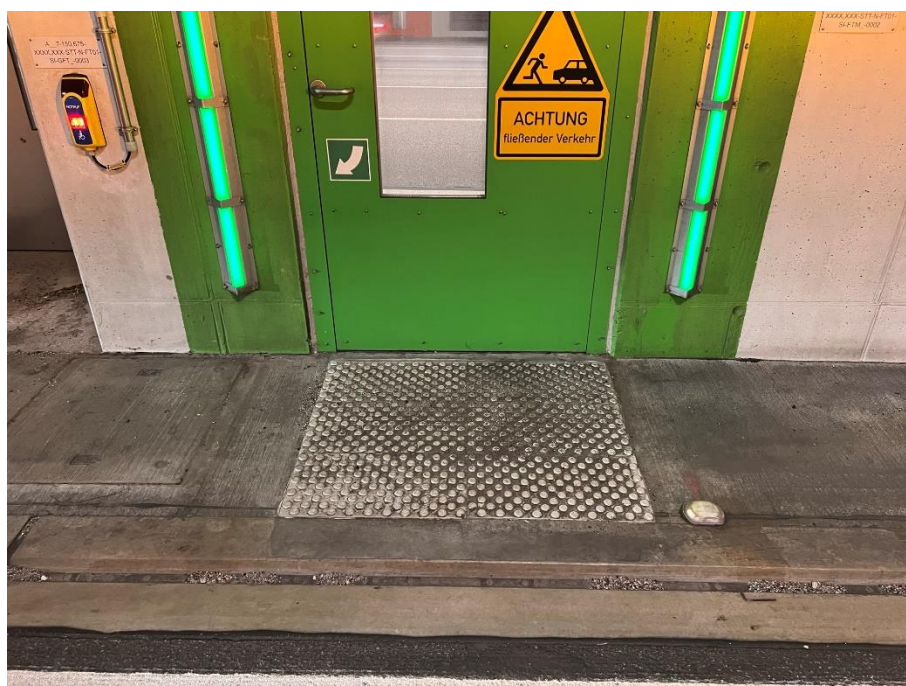
Bild 12: Notausgang im Straßentunnel mit Bodenindikatoren und Taster für die Anforderung von Hilfe im zwei-Sinne-Prinzip (Foto: Boenke)
